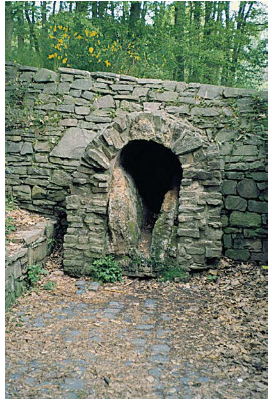
Abb. 3: Eifelwasserleitung nach Köln, Leitungsquerschnitt bei Euskirchen-Kreuzweingarten mit 30 cm starken Kalkablagerungen.
