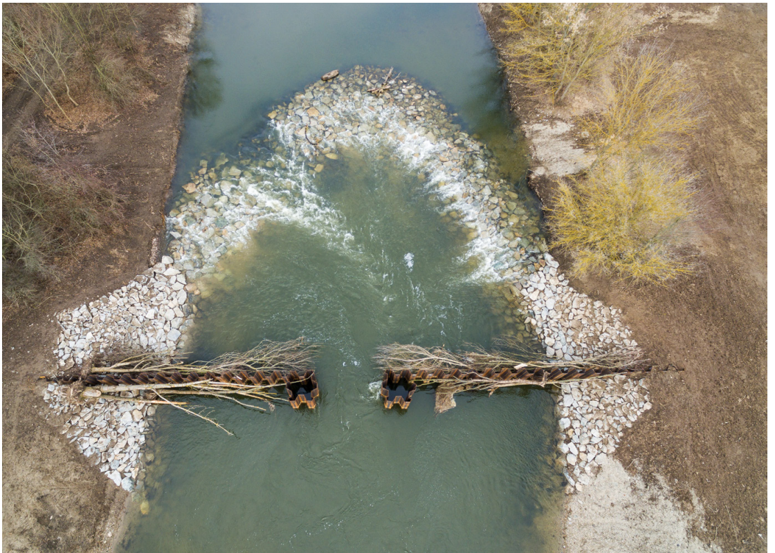
Abb. 22: Teilungsbauwerk beim Durchstich 18
